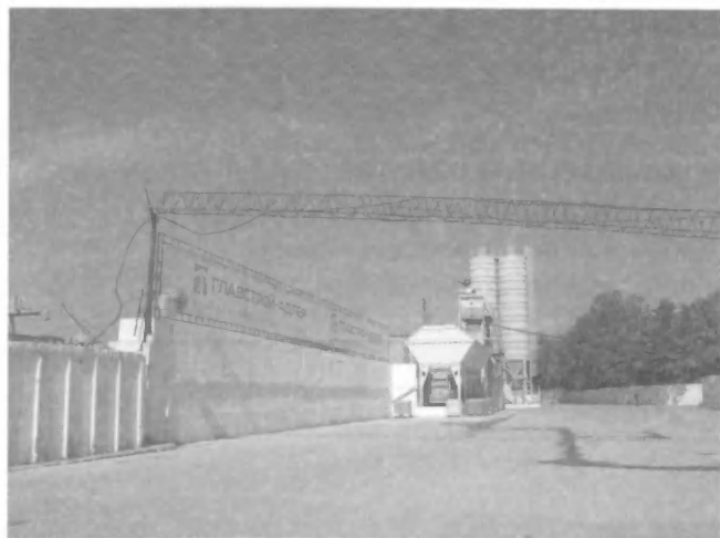
Рис. 1. Бетоносмесительный узел Адлерского завода ЖБИ
